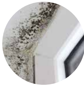
Moisissures sur les murs
